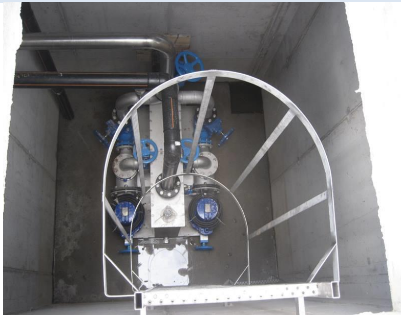
Vgrajena oprema v črpališču
