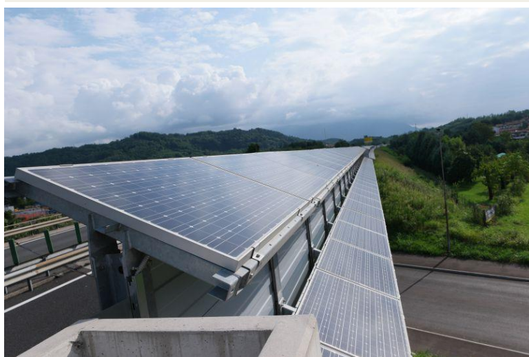
Sončna elektrarna na protihrupni ograji, Šempeter-Vrtojba
